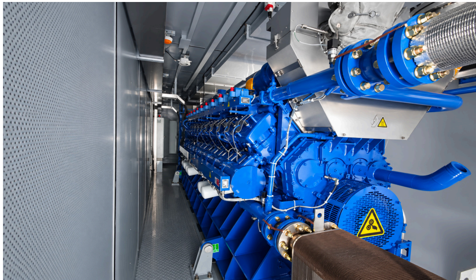
Innenansicht: Motor, Generator und Wartungszugang
