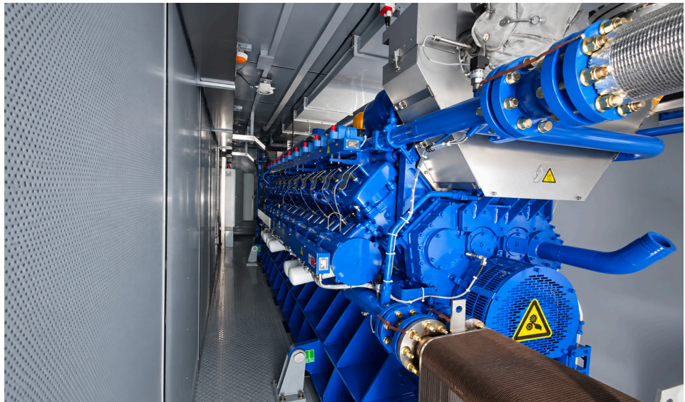
Vista interior: motor, alternador y acceso de servicio
