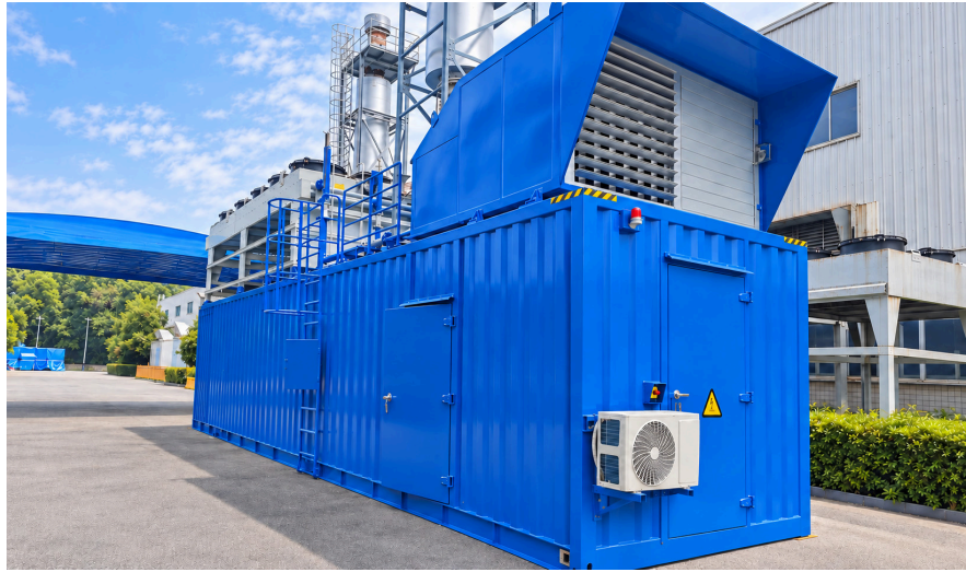
Vista exterior: envoltente, refrigeración y ventilación
