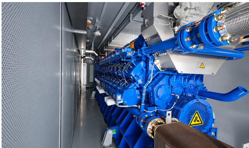
Внутренний вид: двигатель, генератор и сервисный доступ
