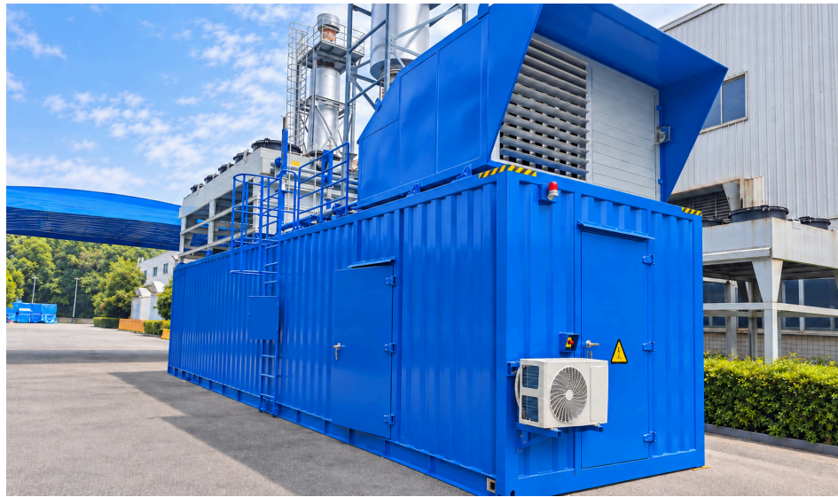
Außenansicht: Einhausung, Kühlung und Belüftung
