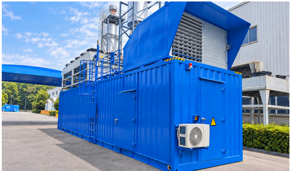
Контейнер, охолодження та вентиляція
