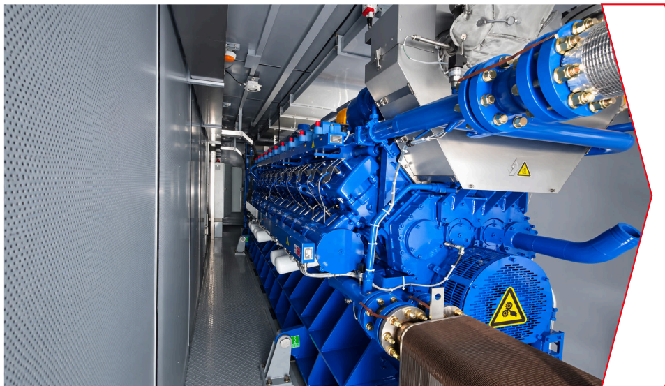
Motorraum und Wartungszugang
