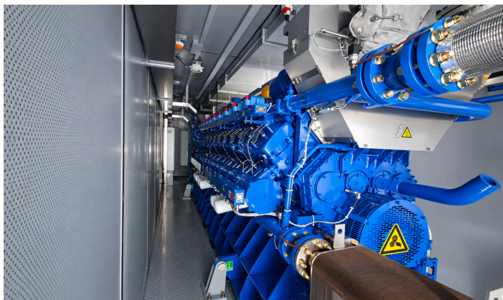
Compartimento do motor e acesso para manutenção
