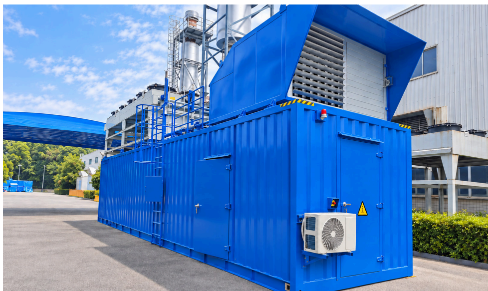
Contêiner, equipamentos de resfriamento e ventilação
