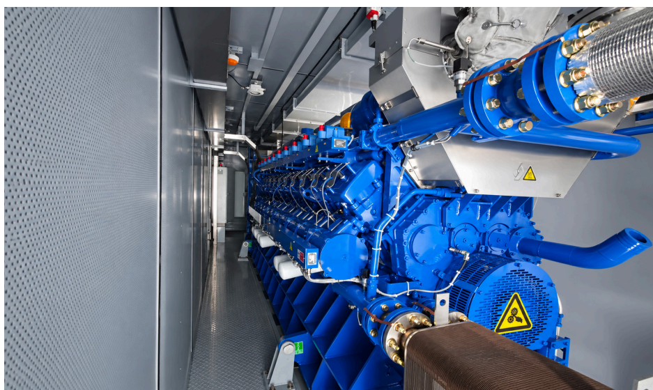
Vista interna: motor, alternador e acesso para manutenção
