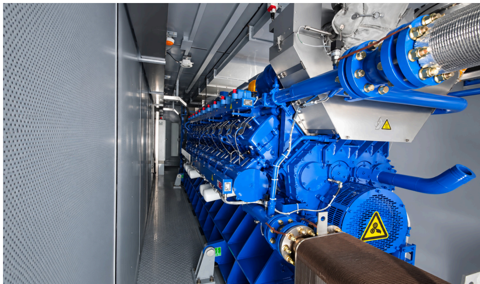
Vista interna: motor, alternador e acesso para manutenção
