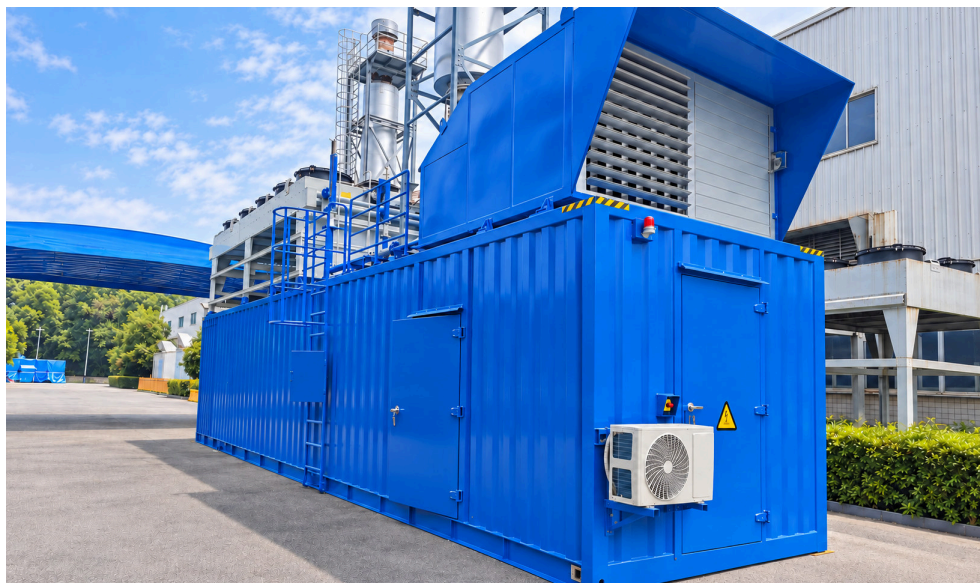
Contêiner, equipamentos de resfriamento e ventilação
