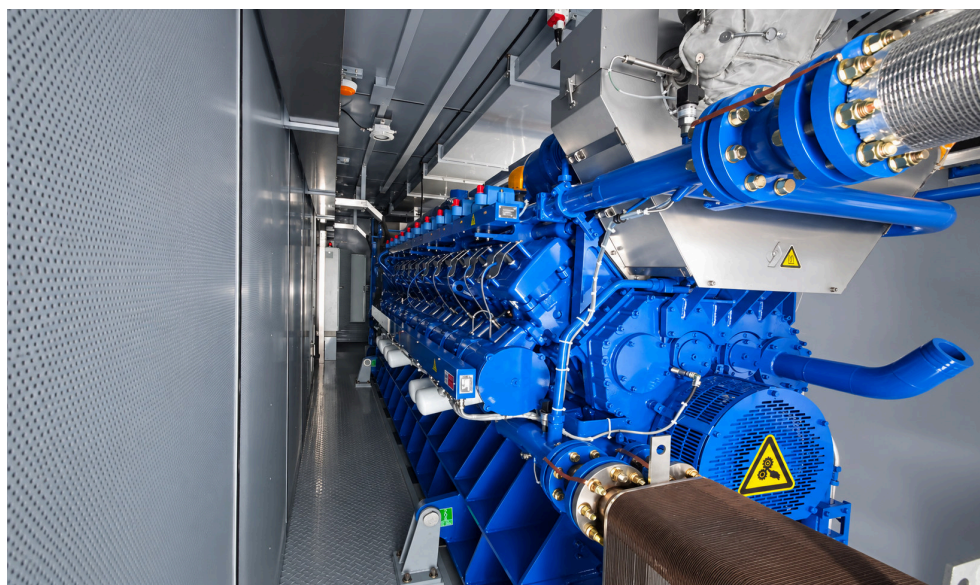
Compartimento do motor e acesso para manutenção
