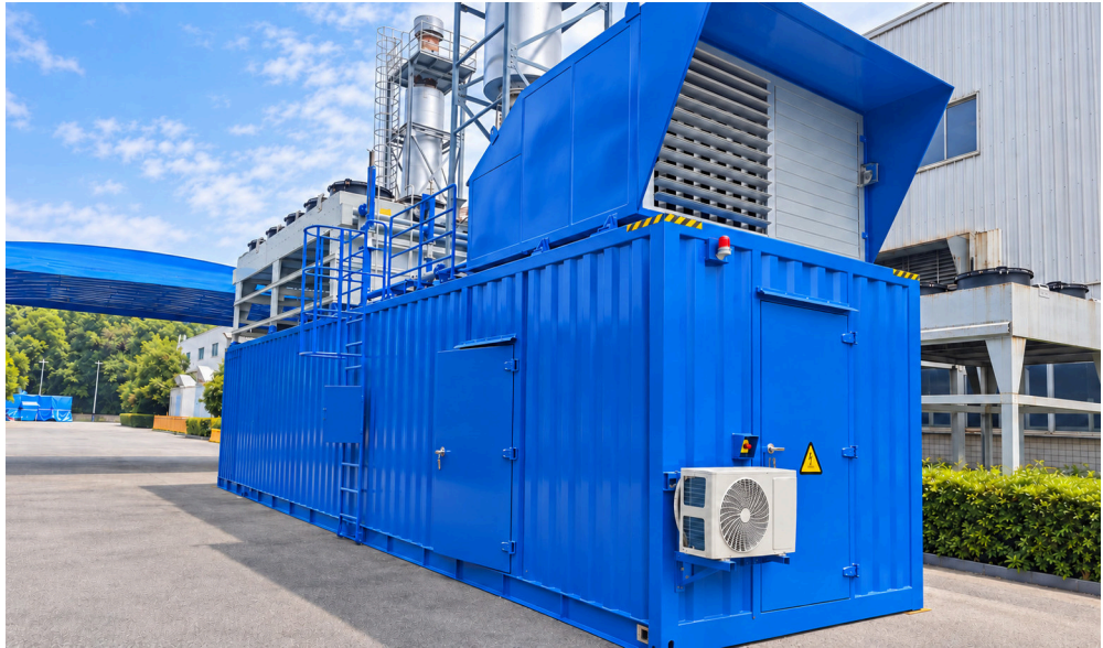
Widok zewnętrzny kontenera, chłodzenie i wentylacja
